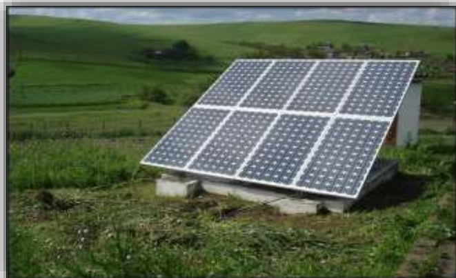
Solar panel Günəş paneli
